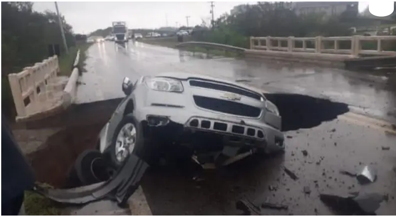
Ponte no trecho entre free way e Santo Antônio da Patrulha, na RS-474, está interditada; picape caiu em uma cratera
